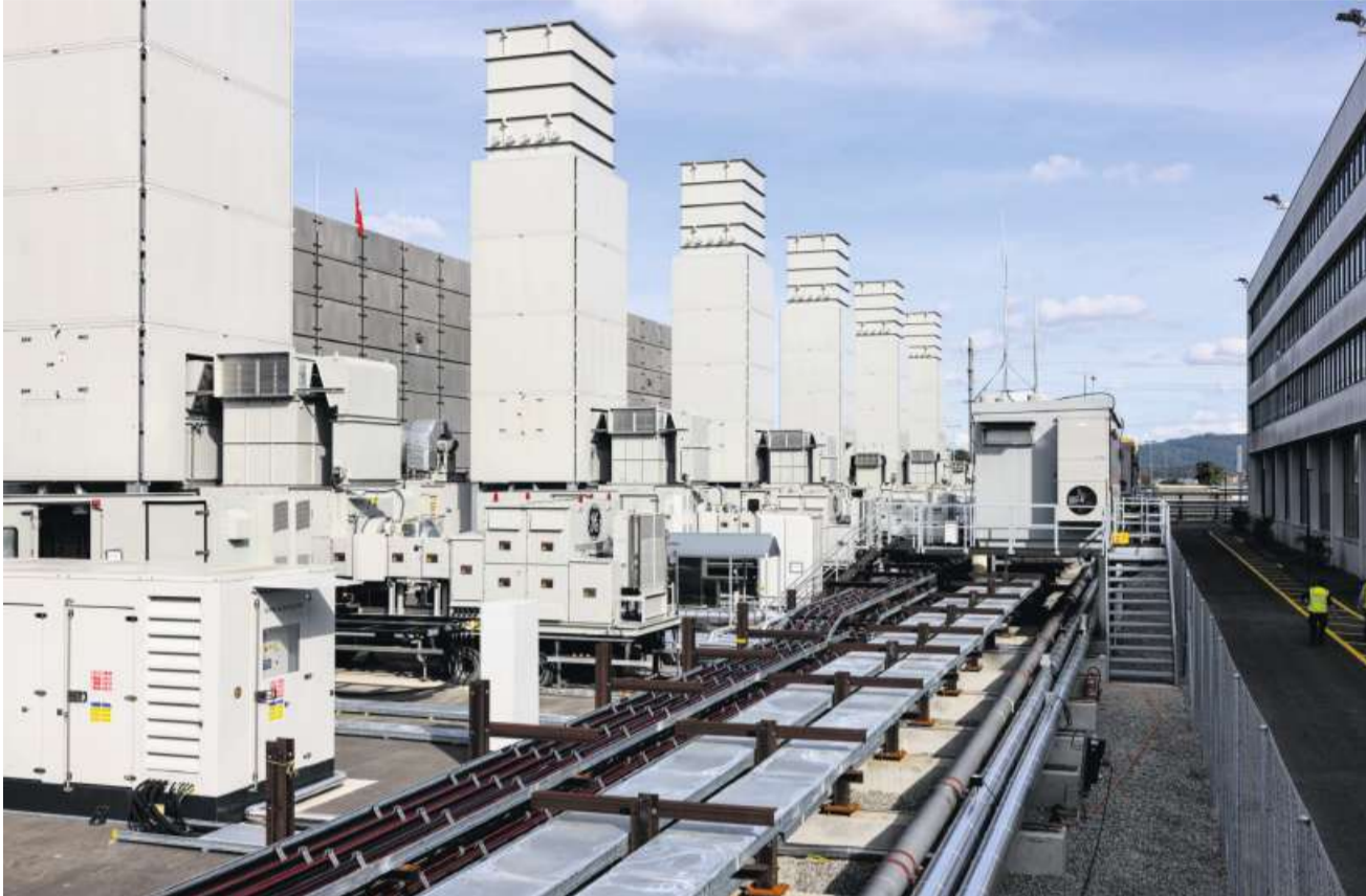
Noch bis Ende 2026 liefern die Gasturbinen in Birm Strom, wenn es zu einem Engpass kommt. Danach sollen neue Reservekraftwerke zum Einsatz kommen.
