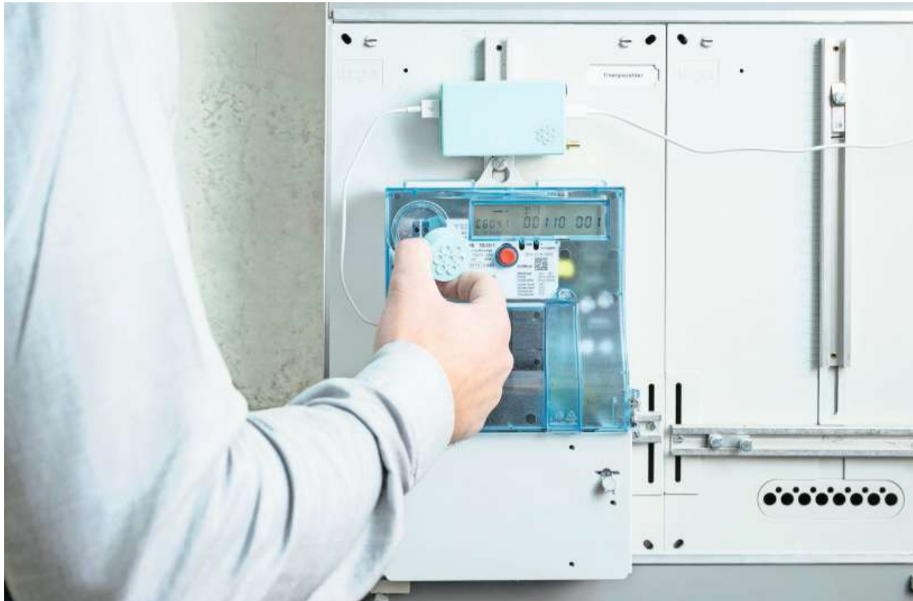
Das Herzstück der Lösung von Aliunid: Ein Gerät mit Sensoren liest am Stromzähler den Verbrauch ab.
